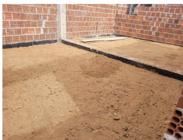
FOTO 18: Aterramento de ambientes;
